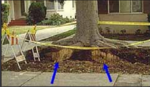
Raíces cortadas durante la reparación de aceras.
